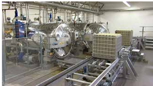
Sistema de transporte con transportadores fijos
